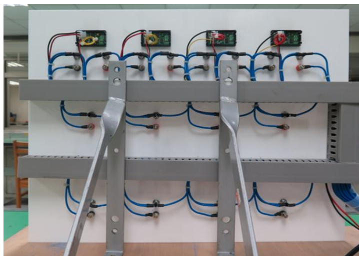
圖 6、實際接線面板 RWP(背面)(資料來源：本研究拍攝)
